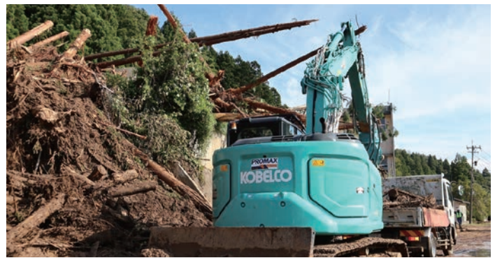
■能登豪雨後の道路啓開の様子。2024年9月25日撮影 (写真:日経クロステック)
