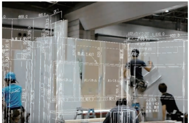
●ARゴーグルを通して見た現場。CAD図面を現場と同じ大きさで重ねて見られるため、出来形管理をスピーディーに行える(資料:インフォマティクス)
