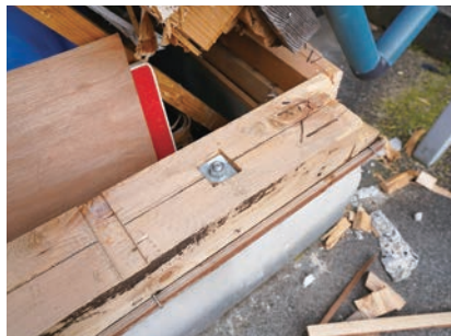
倒壊した戸建て住宅の土台付近。土台と基礎は金物で固定されている。柱脚部にホールダウン金物などが見当たらない
