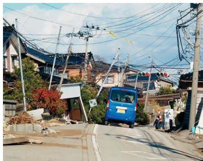
液状化によって道路だけでなく、宅地もうねっていることが分かる
