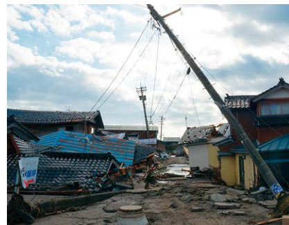
津波被害を受けた石川県珠洲市宝立町の鶏飼集落の状況
