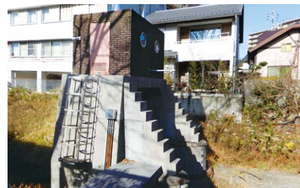
▲ロボット水門を横から見たところ。操作室は1992年の改修工事で取り替えられたが、デザインは踏襲された。
