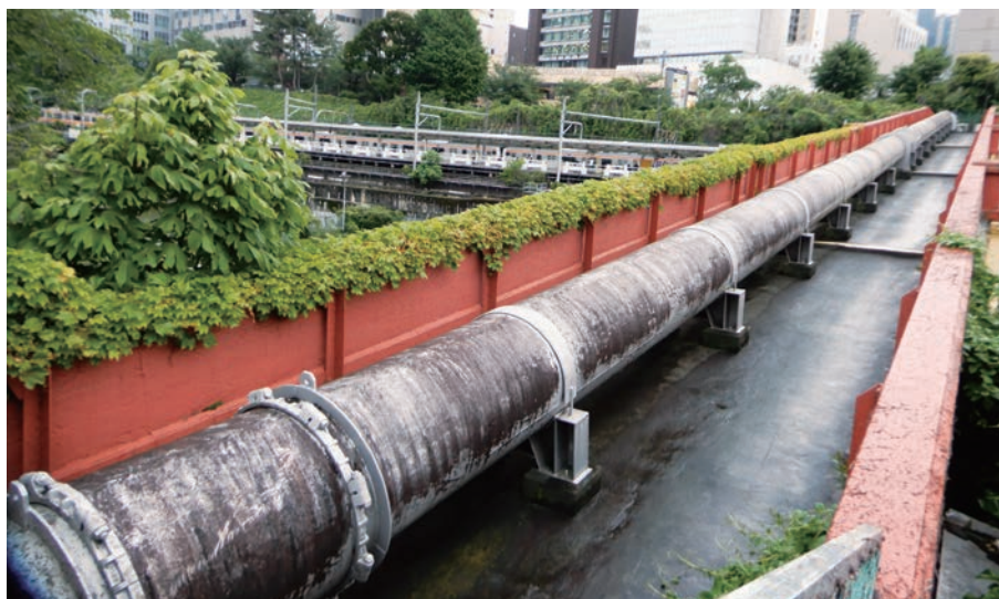
▲市ヶ谷水管橋を靖国通り側から覗き込むと、太い鉄管が見えた。道路からは欄干が目隠しになっている。
