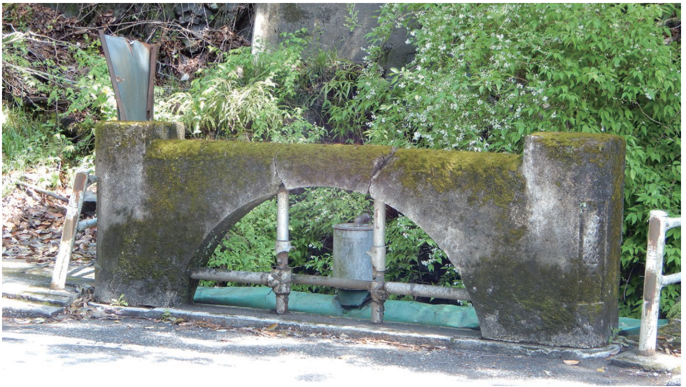
▲ コンクリートの欄干は美しい苔に彩られ、石造のような趣を放つ。建設から80年以上がたち、欄干のアーチは鉄パイプで補強されていた。
