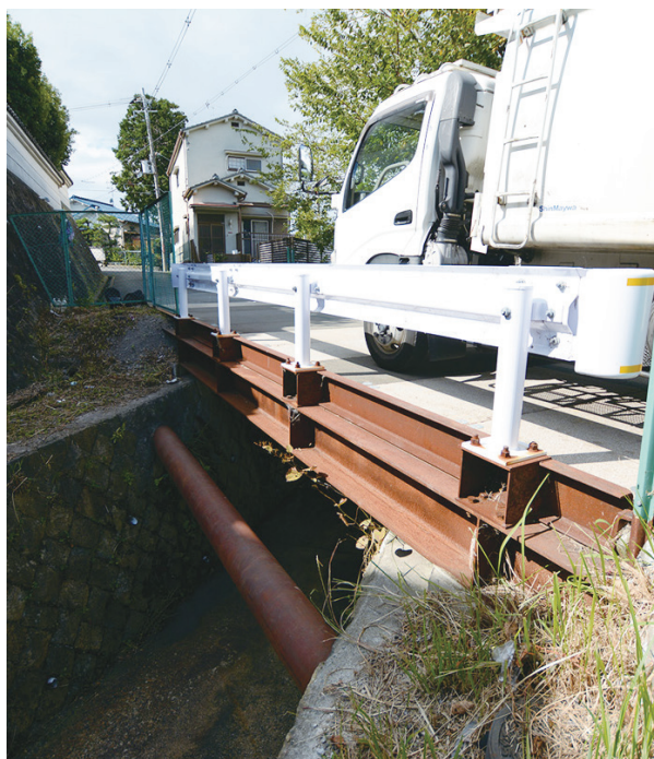
大阪府枚方市で架け替えられた仮設橋 (写真:日経コンストラクション)
