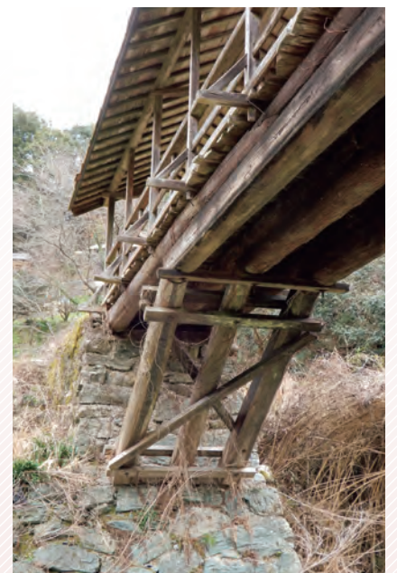
構造は「方丈式」と呼ばれるラーメン構造の一種。斜めになった左右2組の橋脚で支える。
