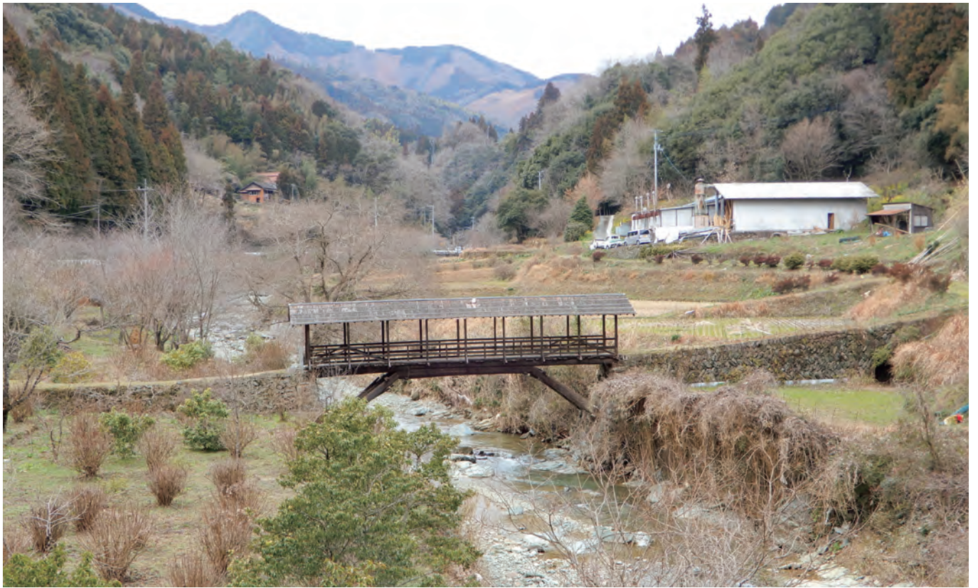
田丸橋の遠景。地元の保存会の人たちによって大切に管理され、いったんはトタンに改修された屋根も、元の杉皮葺きに戻されている。全長14.08m、幅2.09m。
