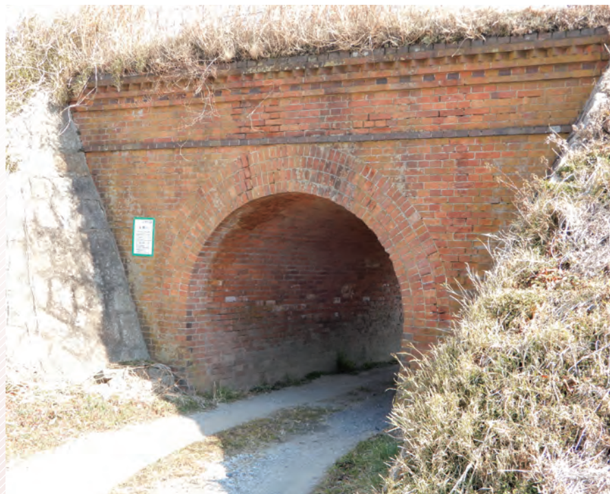
御庄野橋梁の全景。下を通るときに声が反響することから、地元の子もたちは「わんわんトンネル」と呼んでいるとか。
